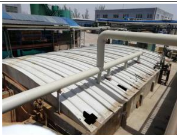
废水中间调节池封闭设施
