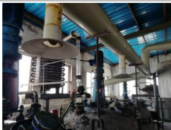
固体料投加废气收集设施
