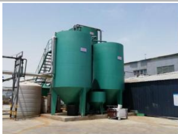
废水芬顿氧化处理装置区
