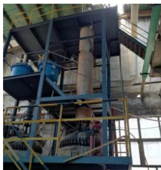
硫酰氯车间精馏塔
