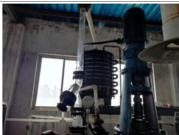
反应釜废气收集冷凝设施（片式冷凝器）
