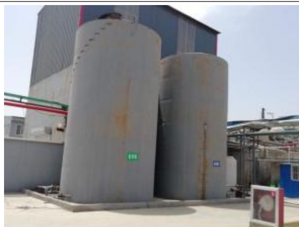
外排废水暂存罐
