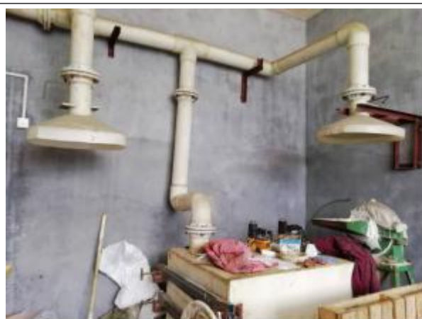
破碎设施及废气收集设施
