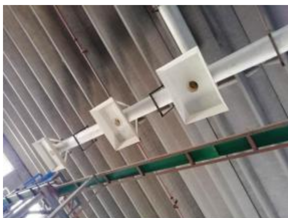
三嗪车间废气收集设施
