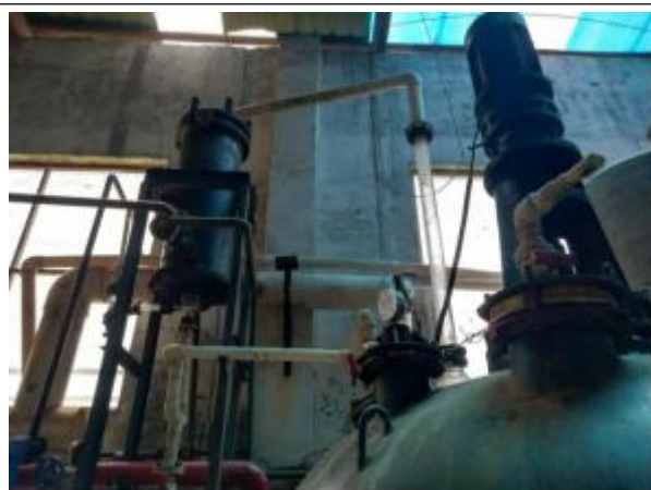
反应釜废气收集冷凝设施（立管式冷凝器）
