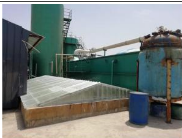
废水调节池封闭设施
