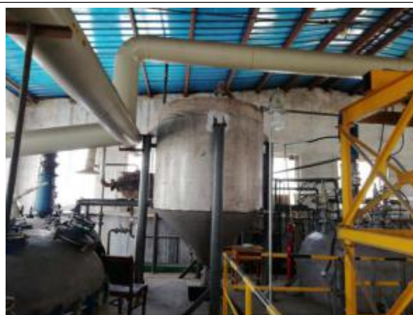
氯代醚酮车间沉降槽
