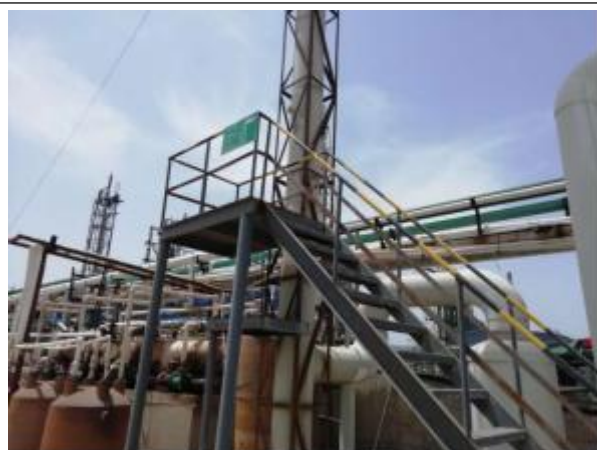
废气检测平台及采样口设置
