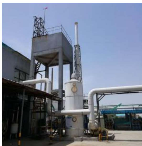
硫酰氯车间废气北侧处理设施
