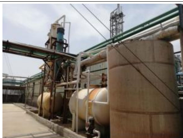
硫酰氯车间工艺废气降膜吸收+冷凝装置
