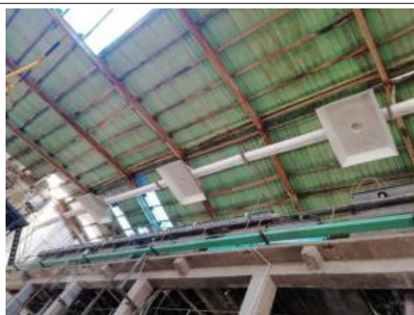
硫酰氯车间废气收集设施
