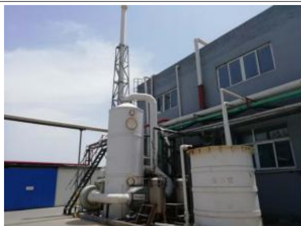
三嗪车间废气北侧处理设施
