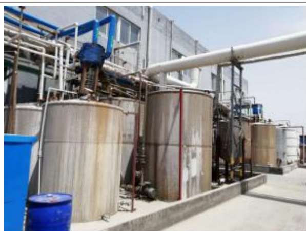
三嗪车间中间物料存放区
