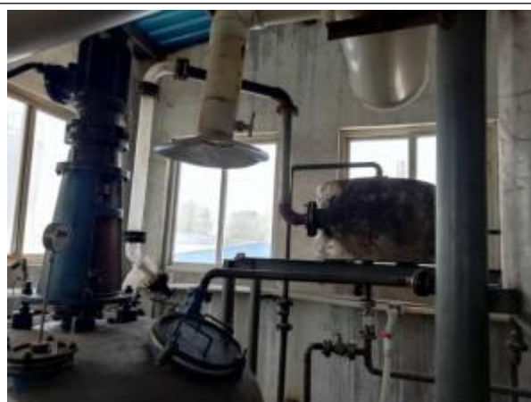
反应釜废气收集冷凝设施（旋板式冷凝器）
