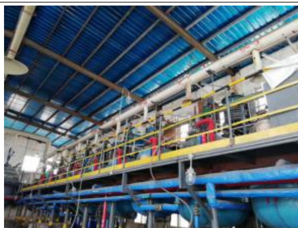
氯代醚酮车间反应釜（北侧）
