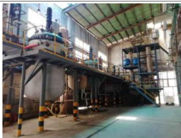
硫酰氯车间反应釜（西南侧）
