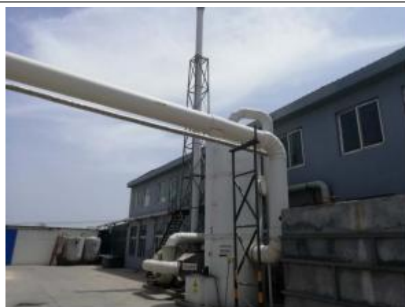
三嗪车间废气南侧处理设施
