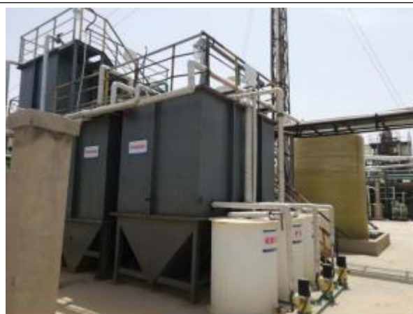
废水中和反应槽及配套盐酸罐
