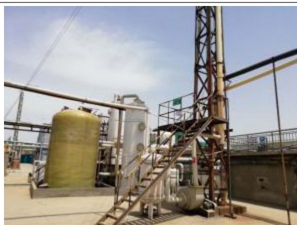
工艺废气处理装置区
