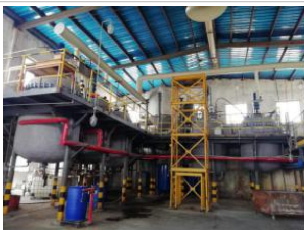
氯代醚酮车间反应釜（西南侧）
